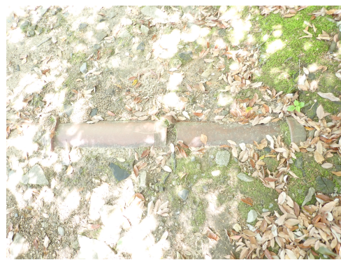
写真 10-2 雨水排水管の露出
